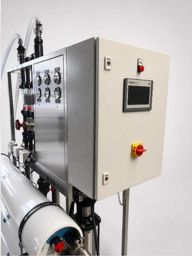
Anlage und Steuerung als abgestimmtes Gesamtsystem
