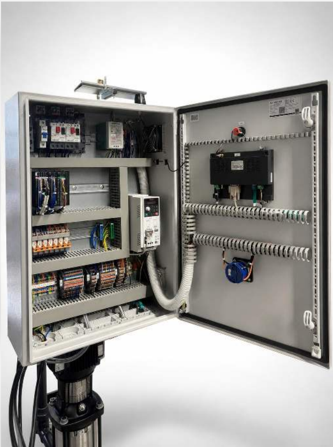
Schaltschrank – aufgebaut, verdrahtet und geprüft
